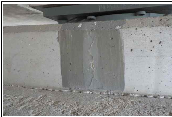
손상위치 : 받침장치(P9, SH3)
