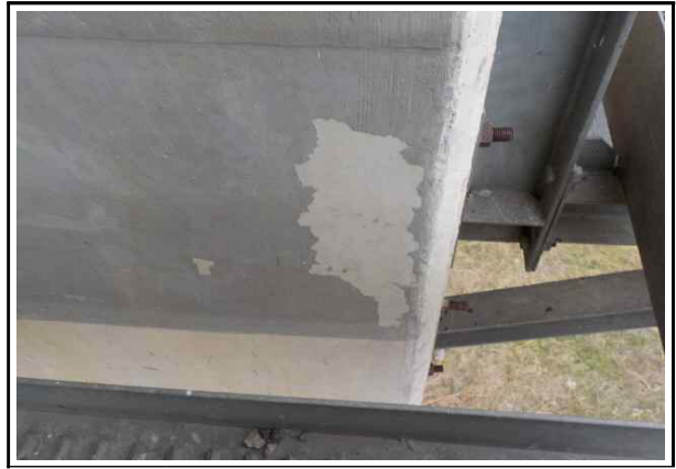
손상위치 : 교각(P8, 교좌면)
