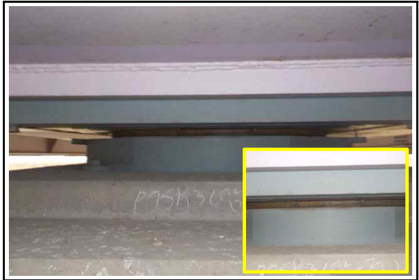
손상위치 : 받침장치(P7, SH3)
