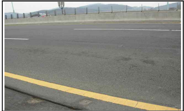
손상위치 : 교면포장(S2, 안심방향)
