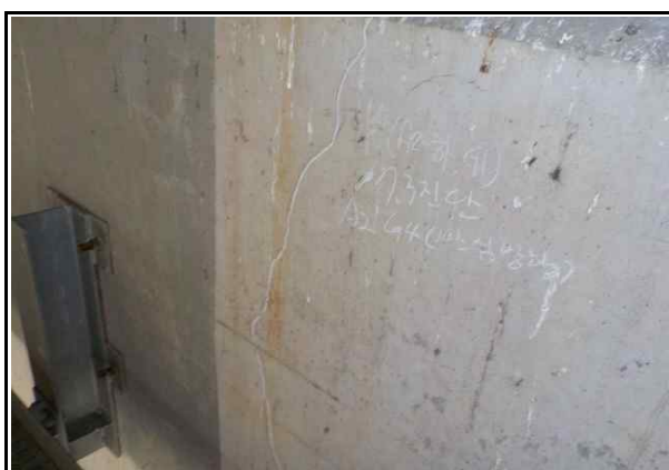
손상위치 : 교각(P3, 코핑부)
