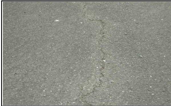
손상위치 : 교면포장(S6, 범물방향)
