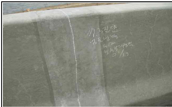
손상위치 : 콘크리트방호벽(S11, 범물)
