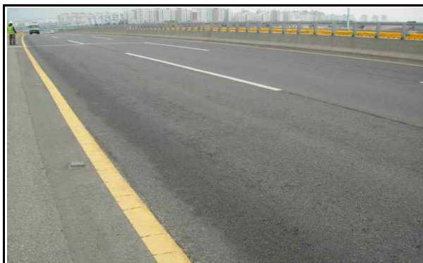
손상위치 : 교면포장(S4, 안심방향)
