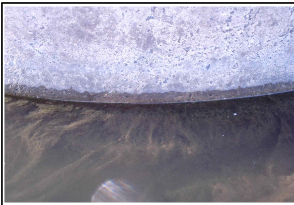
손상위치 : 교각(P7, 안심방향)
