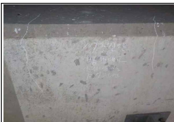
손상위치 : 교각(P7, 코핑부)
