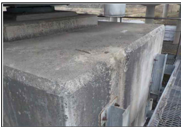
손상위치 : 교각(P7, 코핑부)
