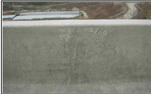
손상위치 : 콘크리트방호벽(S1, 안심)
