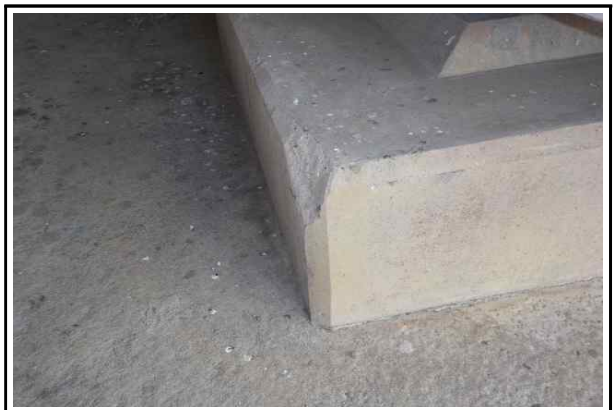
손상위치 : 받침장치(P2, SH2)
