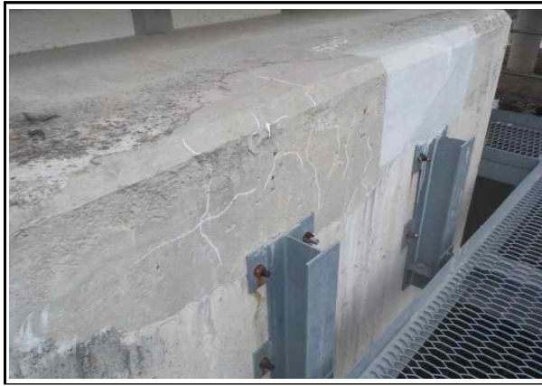
손상위치 : 교각(P7, 코핑부)
