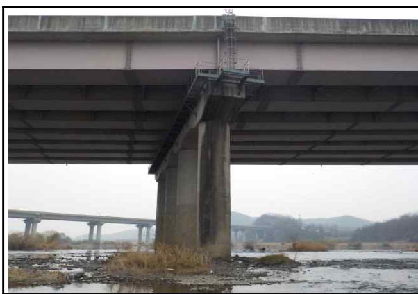
손상위치 : 교각(P7, 기둥부)
