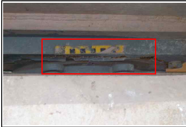
손상위치 : 받침장치(P1, SH6)
