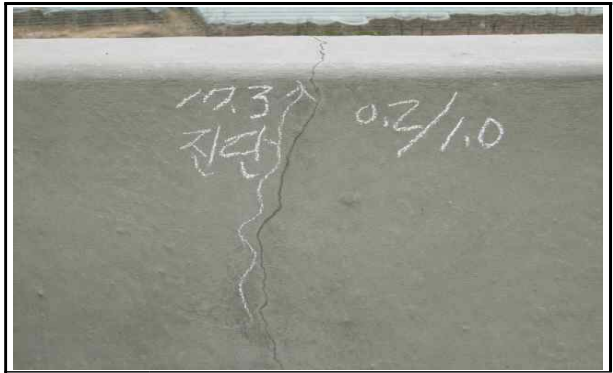
손상위치 : 콘크리트방호벽(S2, 안심)
