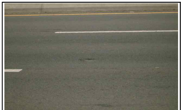
손상위치 : 교면포장(S2, 안심방향)
